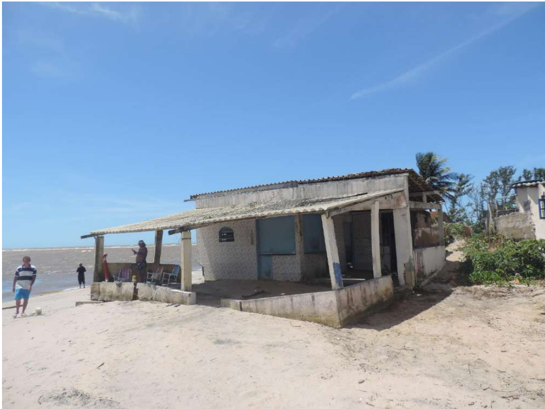
Figura 5.9 – Casa com avarias na região de Atafona devido à forte erosão costeira, resultado das mudanças provocadas no delta do Rio Paraíba do Sul.
